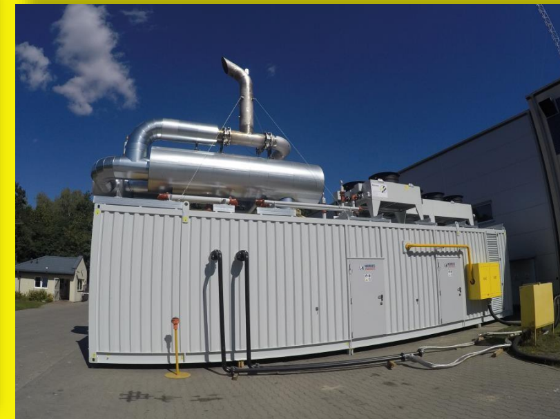
Przykład dźwiękoizolacyjnej zabudowy kontenerowej produkcji Horus Energia dla zespołów kogeneracyjnych
