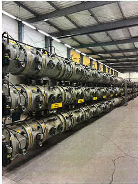
Rozdzielnia wnetrzowa GIS 110 kV – widok od strony odłączników
