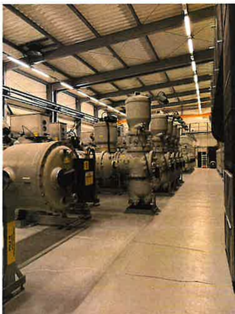
Rozdzielnia wewnętrzna GIS 110 kV – widok od strony szyn zbiorczych
