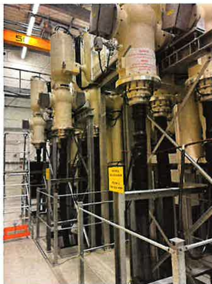
Rozdzielnia wnetrzowa GIS 220 kV
