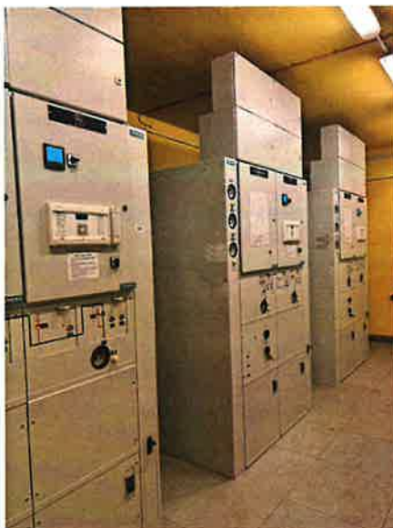
Rozdzielnia wewnętrzna 15 kV
