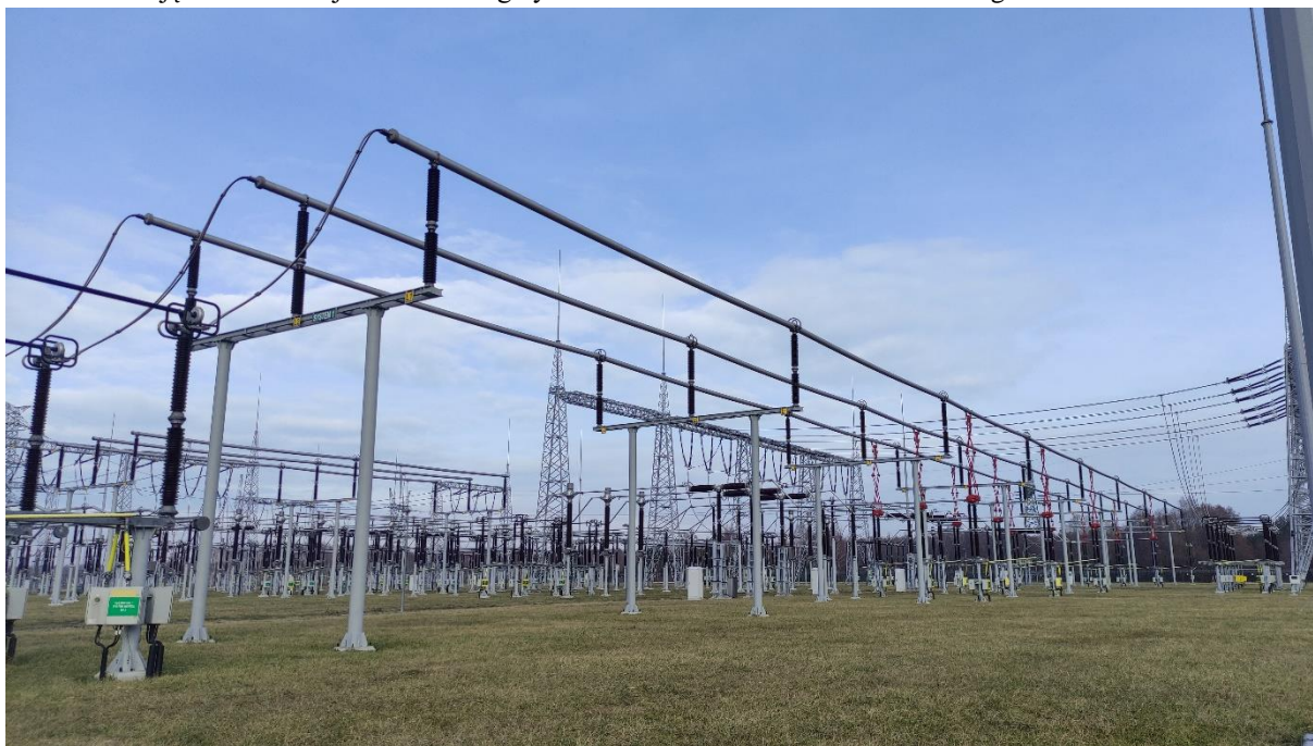
Zdjęcie nr 2. Stacja Elektroenergetyczna 400 kV Stanisławów – widok fragmentu obiektu.
