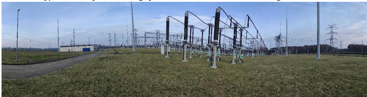
Zdjęcie nr 3. Stacja Elektroenergetyczna 400 kV Stanisławów – widok fragmentu obiektu.
