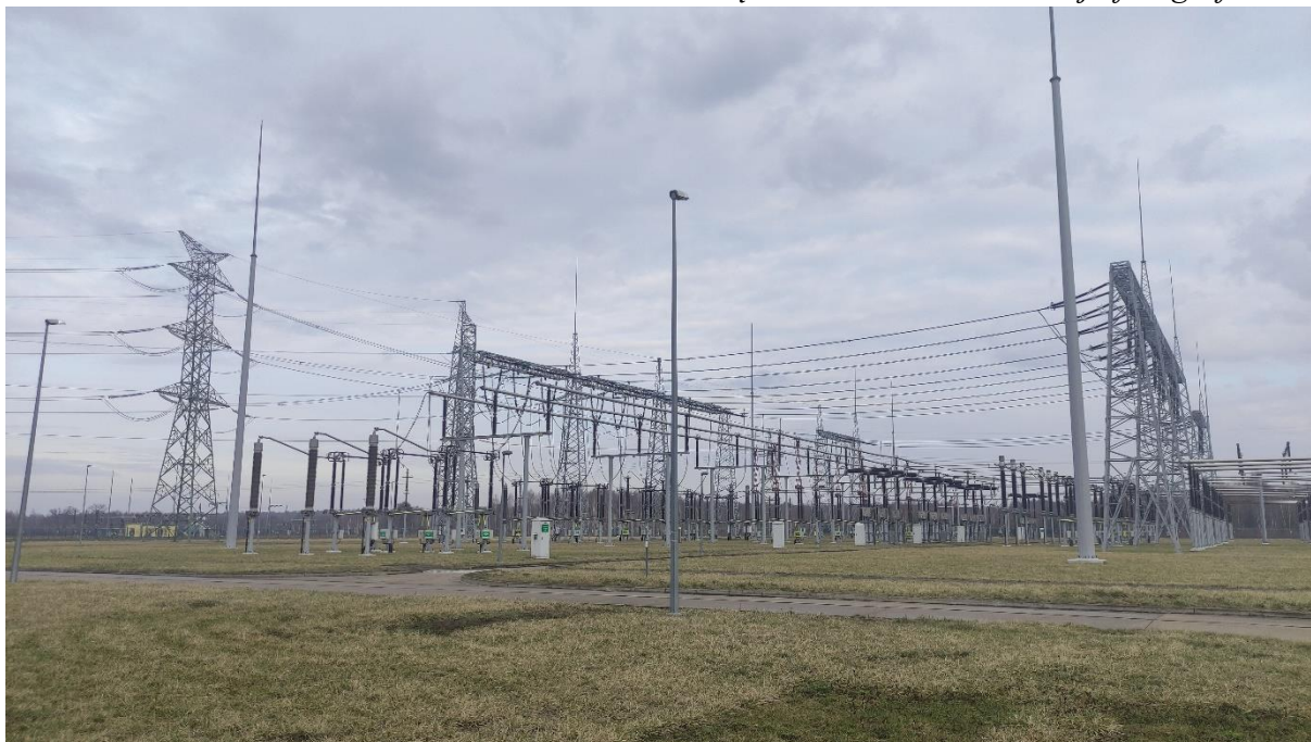
Zdjęcie nr 1. Stacja Elektroenergetyczna 400 kV Stanisławów – widok fragmentu obiektu.
